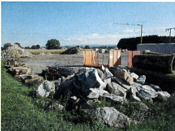
Gelagerte Baumaterialien und Schutt auf Flst. Nr. 2819. (Ehemaliger Erdwall, Aufnahme datum: 30.09.2020)
